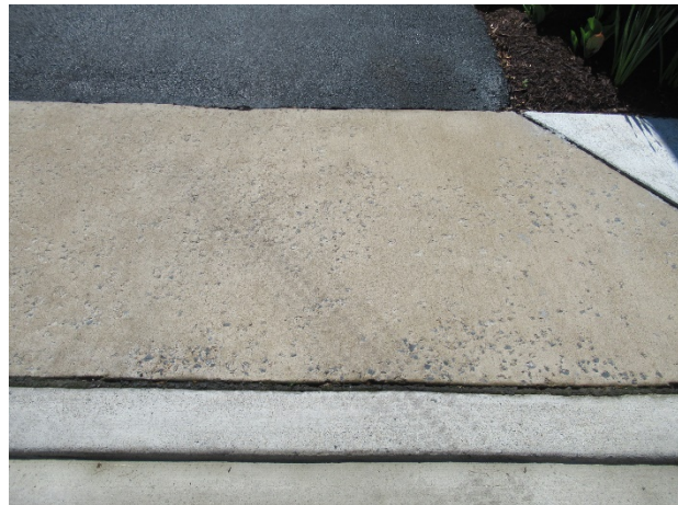
Minor apron spall
