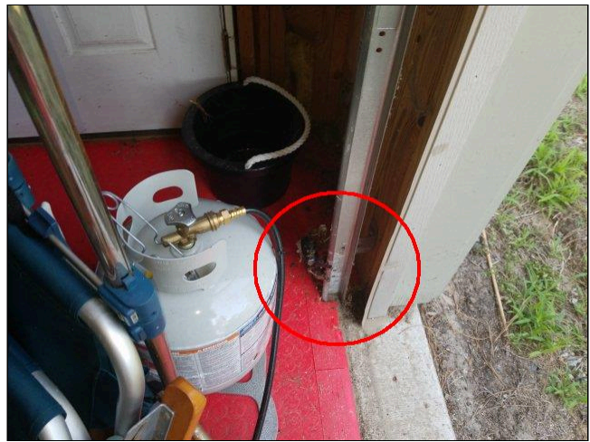
4.9.A DOOR OPERATOR(S) Photo 4
