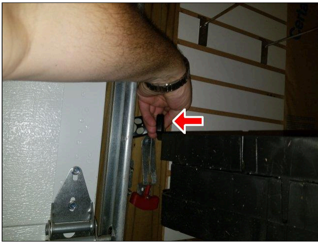
4.9.A DOOR OPERATOR(S) Photo 3
