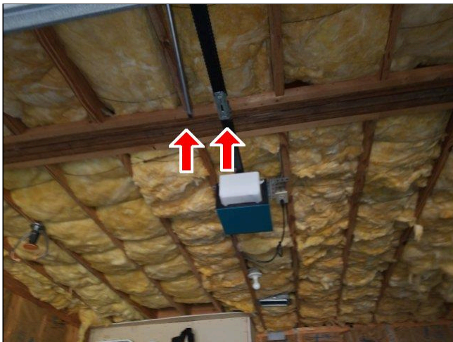
4.9.A DOOR OPERATOR(S) Photo 1
